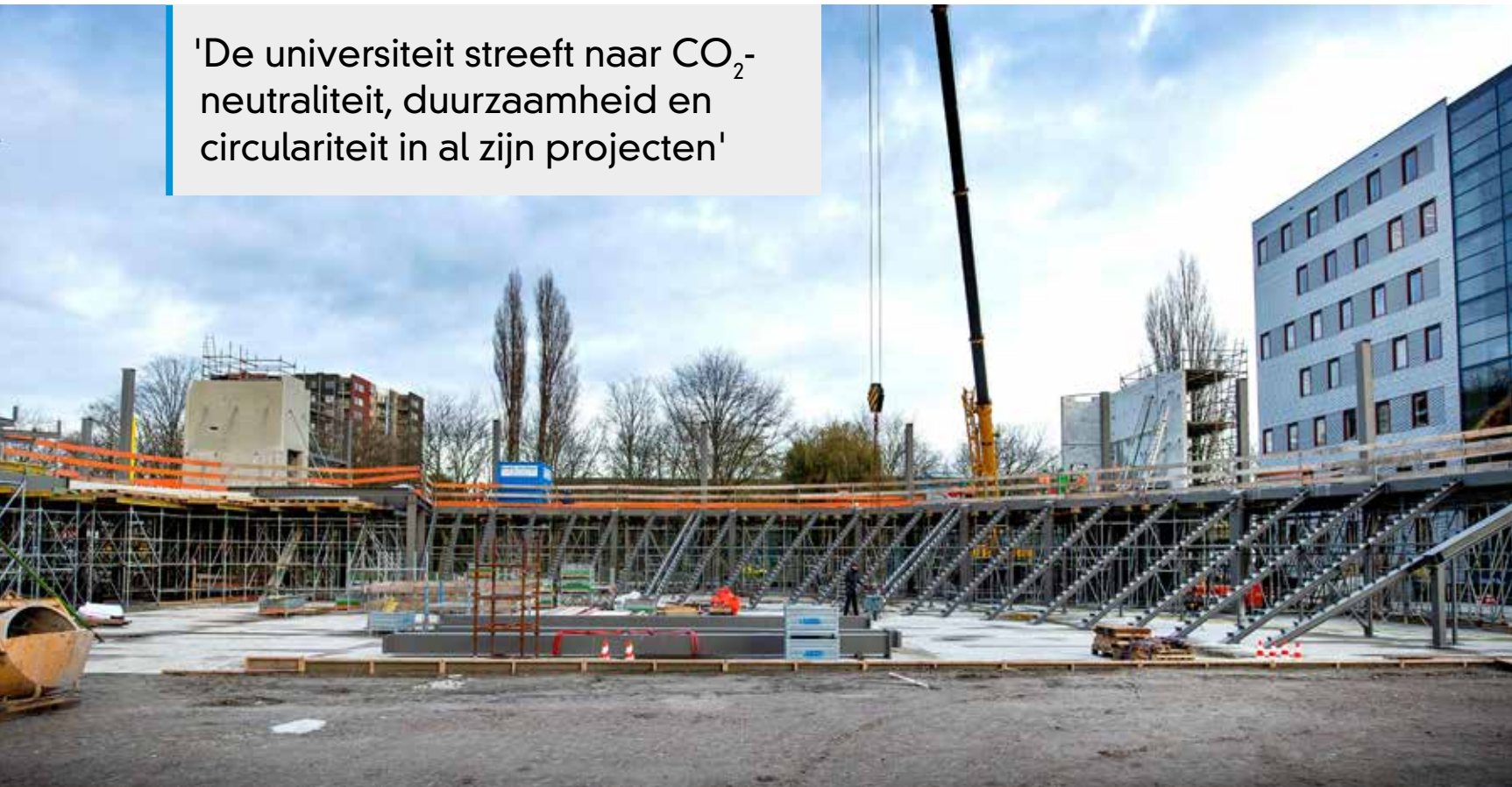
Een beeld van de voorbereidende werken voor de tribune in de grote collegezaal. (Beeld: Guus Schoonewille)
